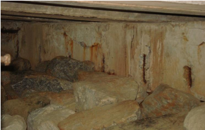
121-5014-0 Spalling on SE End Bent
